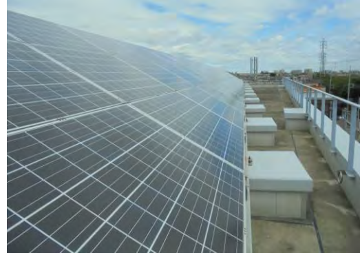
【屋上に設置されている太陽光パネル】
